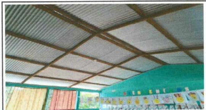
Foto 3: ESTRUCTURA Y CUBIERTA DE LAMINA DENTRO DE LAS AULAS, REQUIEREN SUSTITUCION
